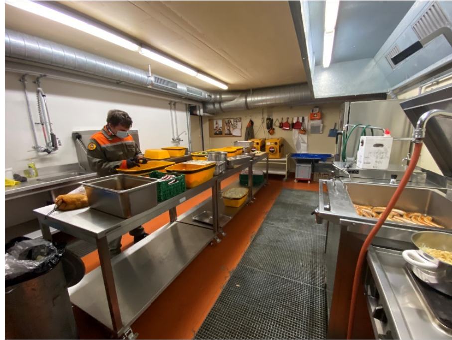
Abb. Küche der ZSO Bachtel in der Anlage Schwarz
